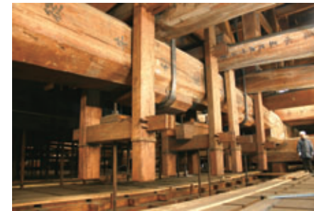
天井より上部の小屋根。白太を削り取り、赤味の心材を使った松の大径材。
