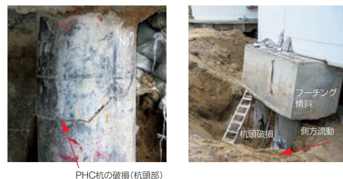
図2 液状化に伴う側方流動により被災した建築施設
