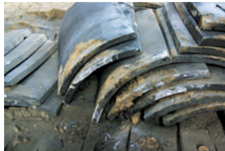
降る直後の平瓦。最も水が入らない水上(瓦尻)に発生している凍害とは異なる風化現象。
