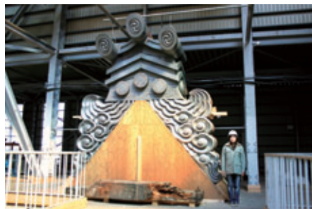
100kgの瓦30ピースによって構成された大棟端部の獅子口(鬼面)は、焼成温度を70℃上げ、焼き直しをした。
