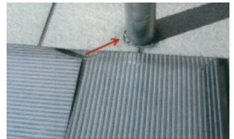
<可動床と手すりの干渉>
