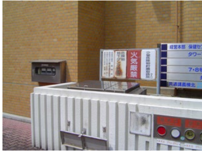
■給油口 油面計、危険物取扱所の標示 ときには消火器の設置
